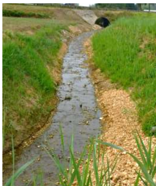
Seuil effacé sur la Sale becque à Wormhout (Août 2020)
