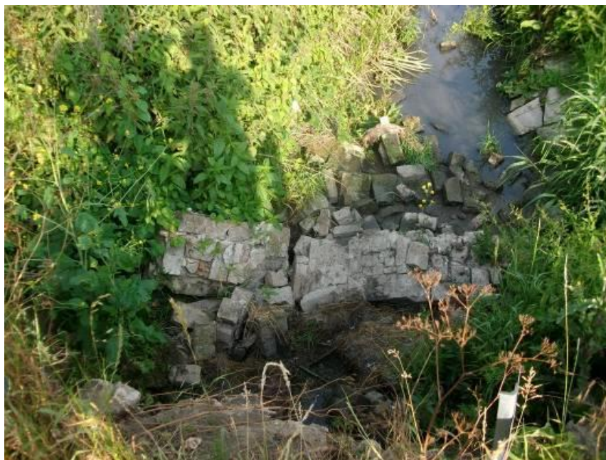
Photographie 7 Effondrement d'un pont-cadre en sortie de buse à Neuve-Chapelle
