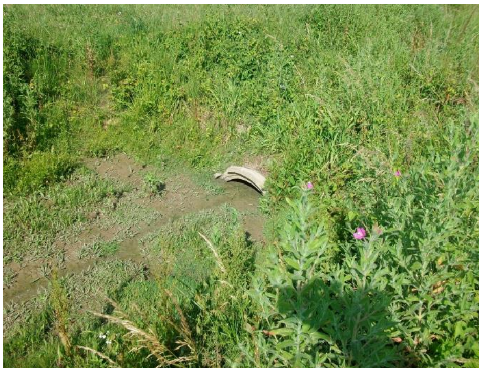
Photographie 5 Certains secteurs présentent des état d'envasement tellement important que le rôle hydraulique est quasi inexistant (courant des Bas Champs)
